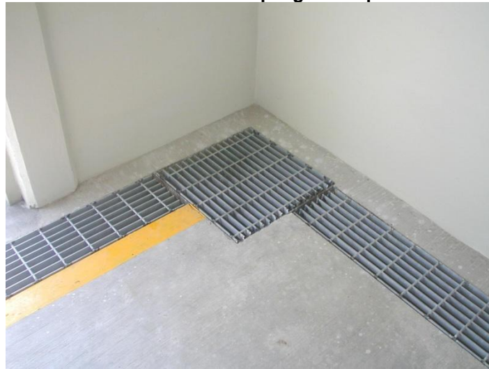
Figura 9. Trampas de contención de derrames en almacenes de residuos peligrosos químicos.
