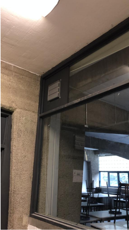
EXTRACTORES EN AULAS
