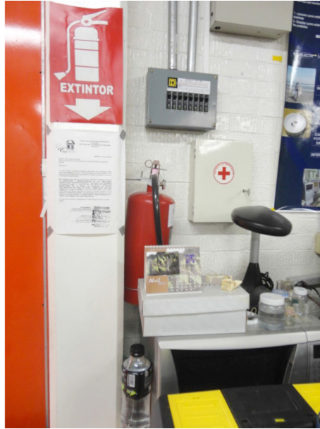
Figura 5.6. Evitar poner objetos que obstruyan a los extintores.
