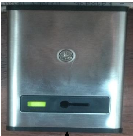
Vista de como se encuentra instalado actualmente
